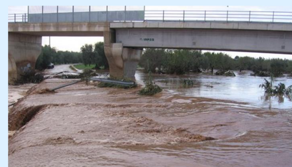
Lama Fascilla - alluvione del 23/10/2005
